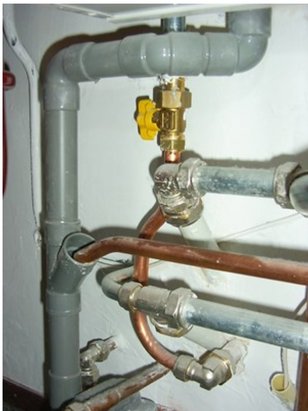
Afb. 9.16 Condensaatafvoer onder CV-ketel, kenmerkend voor HR-ketels
