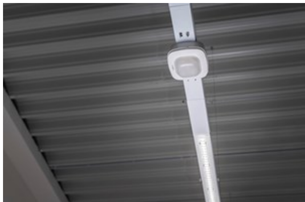
Afb. 14.3 Verlichting met aanwezigheidssensor (bron: Trilux)
