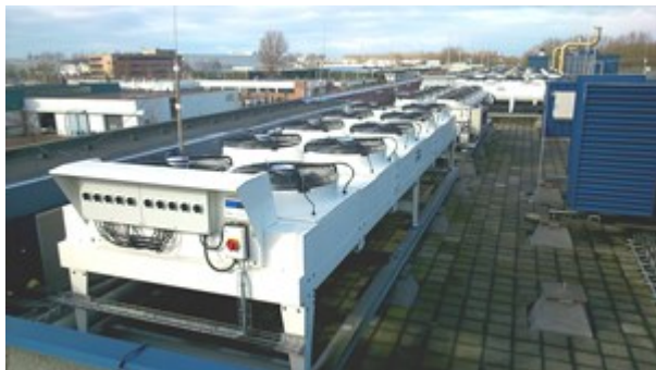
Afb. 10.17 Luchtgekoelde condensor met afgifte aan de buitenlucht
