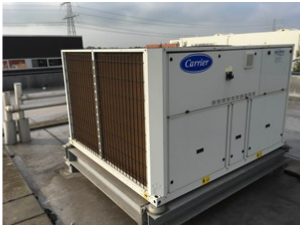
Afb. 10.16 Compressiekoelmachine met distributieleidingen
