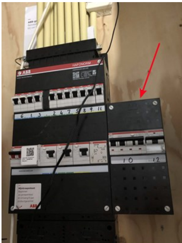
Afb. 15.8 Extra groepen in meterkast voor het PV-systeem
