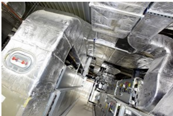
Afb. 11.58 Geïsoleerde luchtkanalen (bron: Rockwool)
