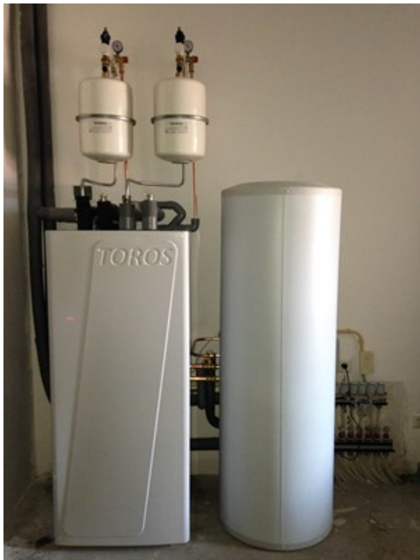
Afb. 10.18 Bodemwarmtepomp met boilervat
