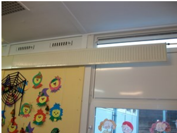
Afb. 11.5 Ventilatie-rooster boven een raam
